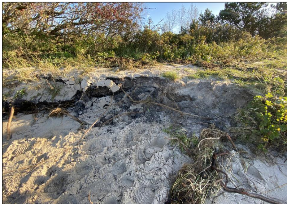
Figur 13. Foto taget ved besigtigelse den 23. oktober 2023 efter stormfloden den 20.-21. oktober 2023. Fotoet viser strækning C tæt ved strækning B. Af strækningen ses, at diget er opbygget af sand med tilsvarende struktur og sammensætning som sandet på stranden. Noget af sandet har en mørkere farve, som skyldes organisk materiale omsat af planterne.
