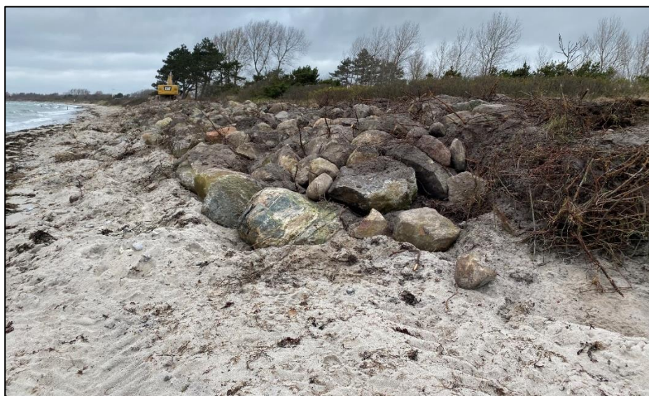
Figur 10. Foto taget ved besigtigelse den 30. marts 2023. Sydøstlige hjørne af matrikel nr. 93, Sønderby, Kegnæs, hvor skråningsbeskyttelsen på digets havværts side begynder. Stenene er gravet ned i stranden, og der er tydelige tegn på grene imellem stenene efter at buskene er fjernet. Rendegravere ses af billedet foran den nærmeste træække.
